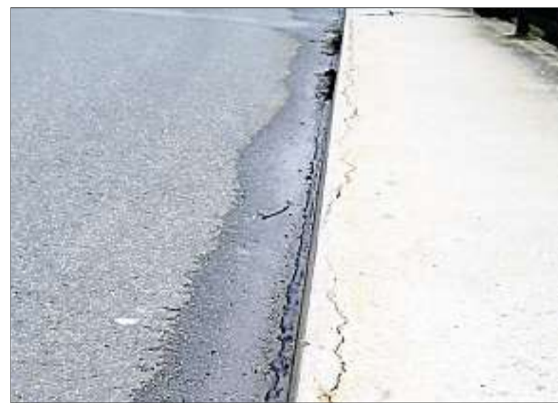
Auf dem Gehweg platzt bereits der Beton auf. Folge: Wasser dringt ein.
