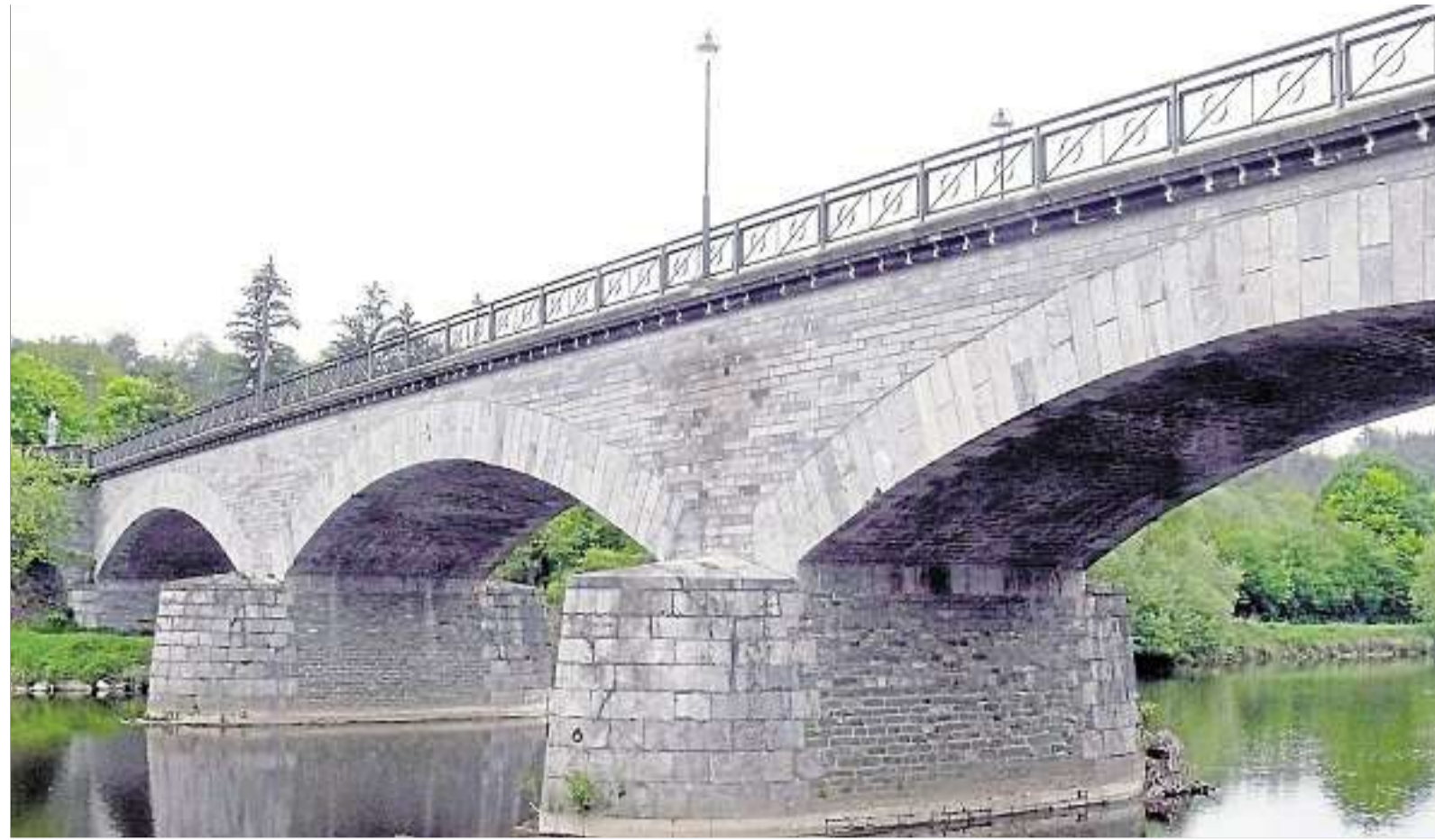
Ein nasser Fleck in der Mitte zeigt, dass die Marmorbrücke undicht ist. Selbst wie hier im Sommer trocknet das Bauwerk nicht mehr ab. Foto: Volkwein
