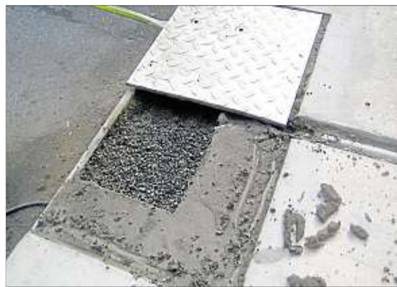
Blick auf eine der schadhaften Dehnungsfugen.
